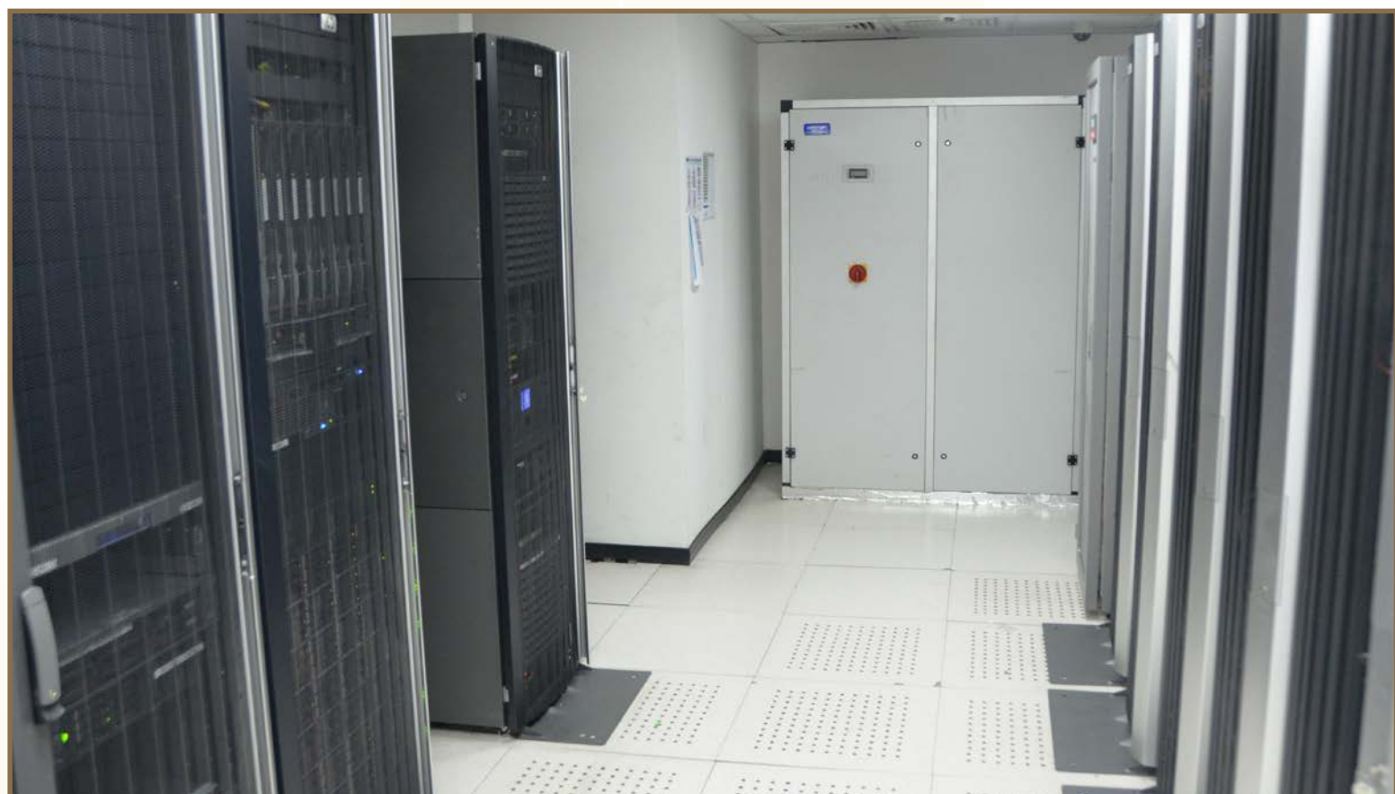
غرفة سيرفرات المعلومات بالمركز
